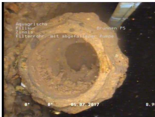
Grundwasserpumpwerk Zinols, Filterrohr mit abgefallener Pumpe
