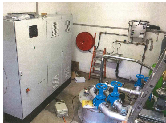
Grundwasserpumpwerk Zinols, neuer Schaltschrank und neue Verrohrung (Fotos: FWBA I. Castelberg)
