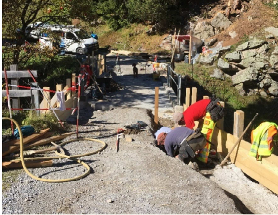
Instandstellung des Kordons und der Anschlussmauern der Brücke Naz im Val Tuors.
