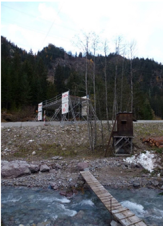
Sicherheitsinstallation für die Überführung des Tragseiles über die Kantonsstrasse (Foto: FWBA P. Müller)
