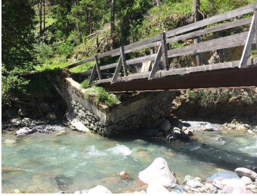
Brücke Ziegelboden: Beschädigtes Widerlager (Fotos: I. Castelberg)
